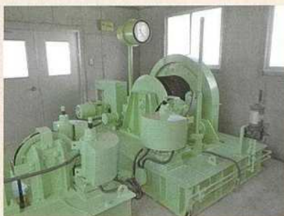
ゲート巻上機 (完成)
